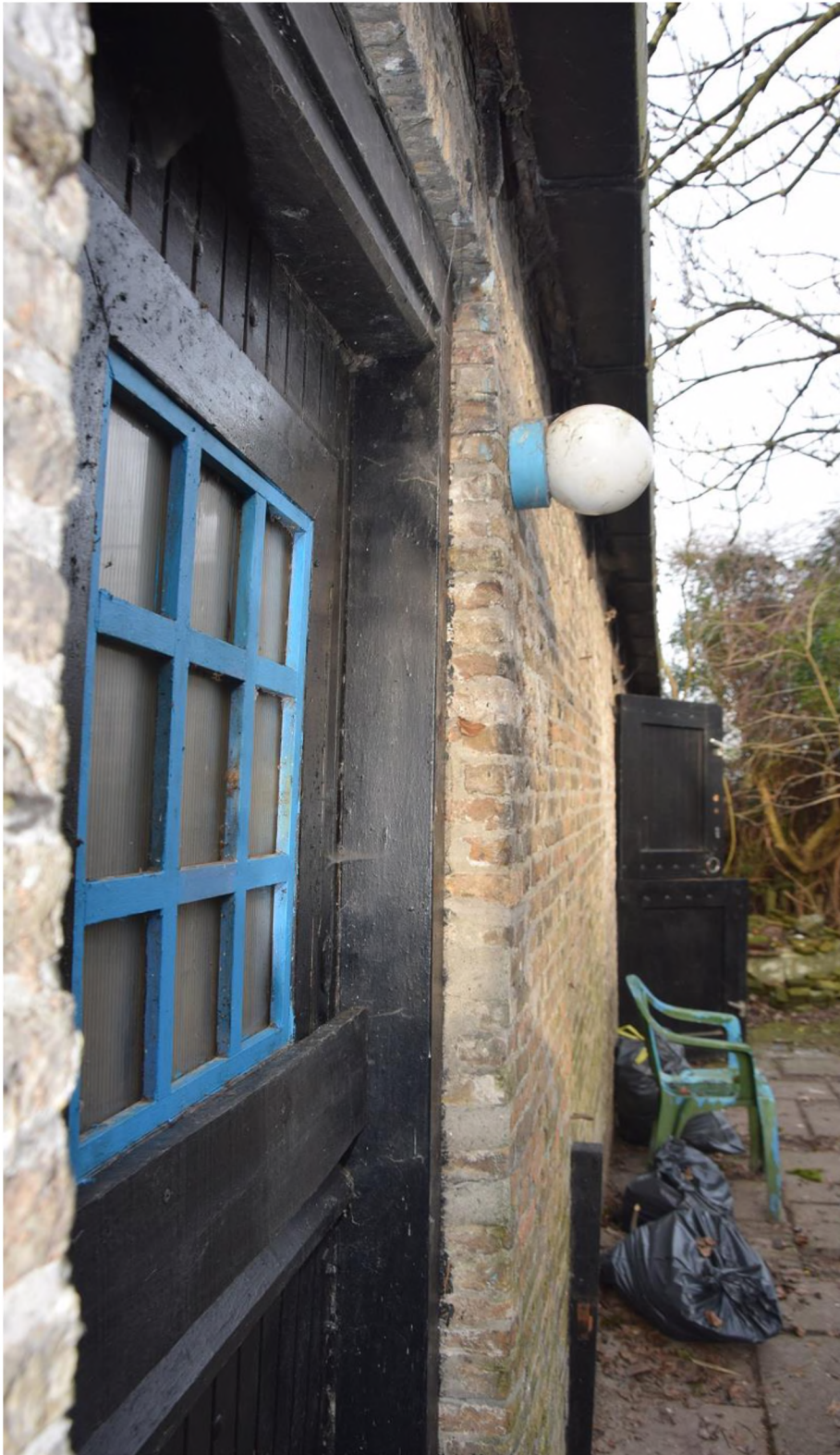
Gevel uit het lood. Hangt 4 cm/m 1 naar binnen
