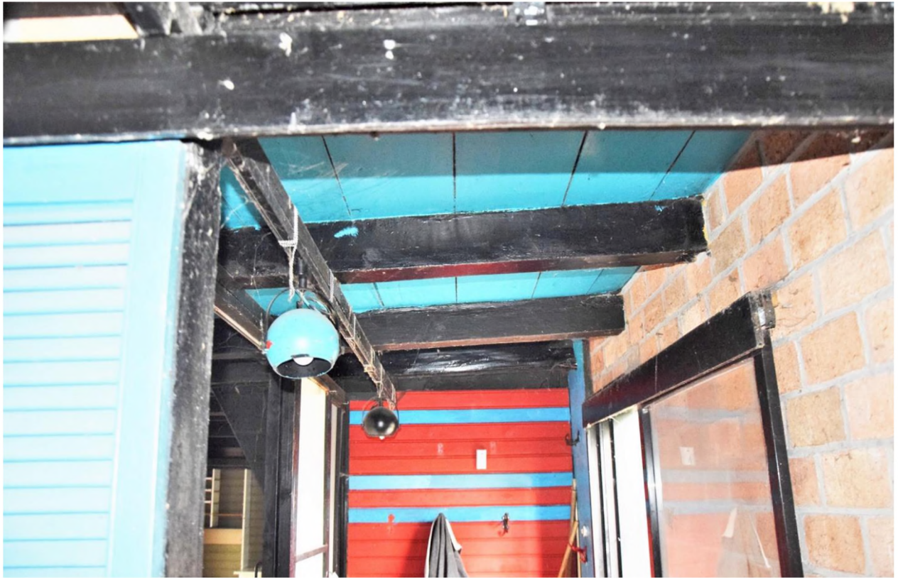
Zolderbalklaag vertoont een grote doorbuiging
