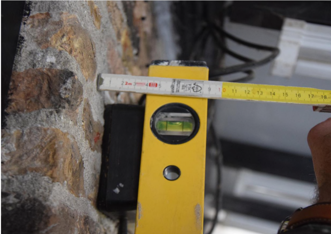
Scheefstand (achter)zijgevel in serre 4 cm/m Horizontale scheurvorming in penant
