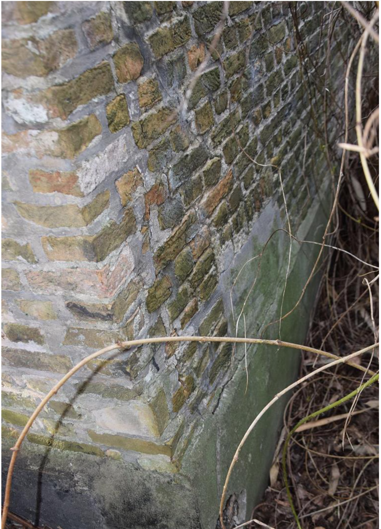
Hoek (voor)zijgevel en (achter)kopgevel gevelmetselwerk verbrijzeld.
