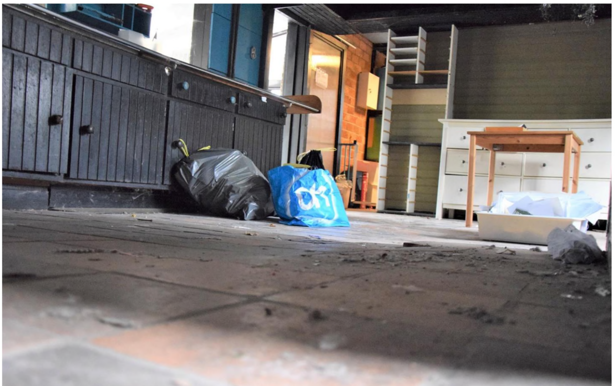
Verzakking van de begane grondvloer
