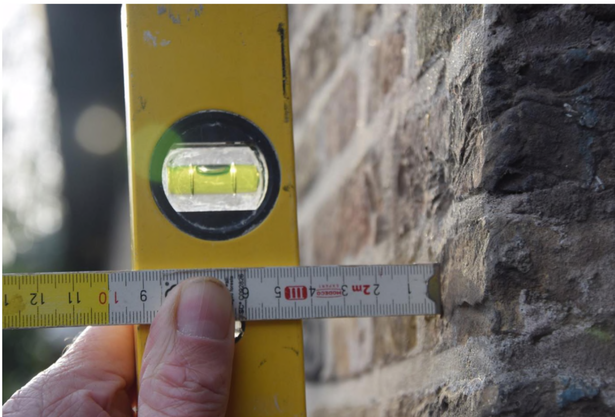
Scheefstand 4,3 cm/m 1 t.p.v. hoek (voor)zijgevel en (achter)kopgevel
