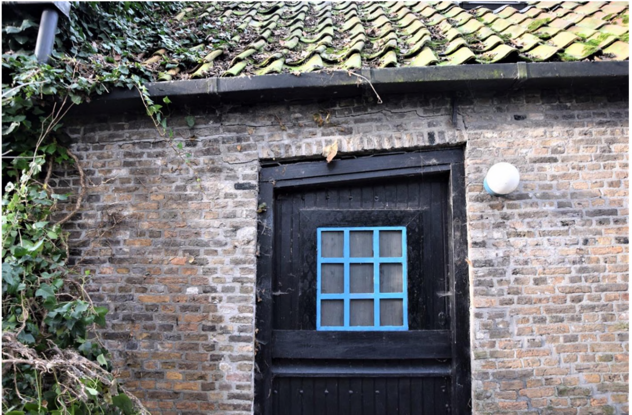
Ernstige verzakking engevelschade. Deur dient permanent ontoegankelijk te blijven!
