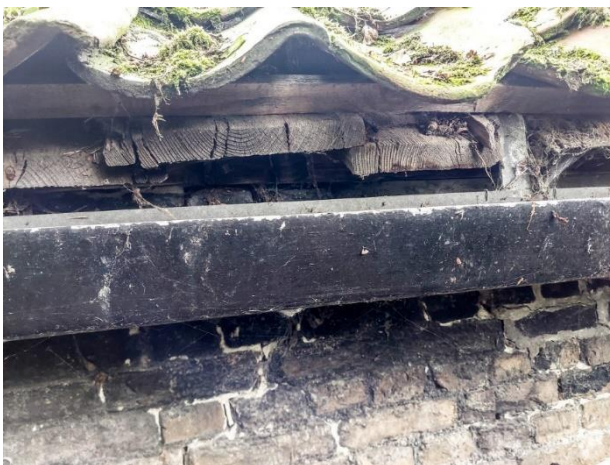
Deel van het dakbeschot, te zien boven de lange oostgevel van bouwdeel 1.
