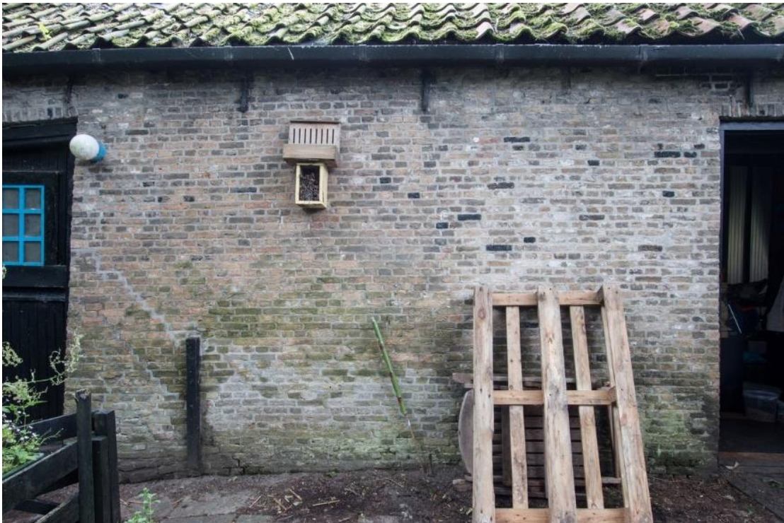
Het metselwerk tussen de deuropeningen bestaat uit verschillende 'soorten' metselwerk. Op de foto is goed te zien dat met name in het bovenste deel van de gevel (kijk vooral boven het pallet) hergebruikte beroete bakstenen zijn toegepast, wat in de twintigste eeuw moet zijn gedaan. In het onderste deel van de gevel ontbreken deze. Er zijn twee verschillende partijen baksteen gebruikt óf er is sprake van een faseverschil in het metselwerk.
