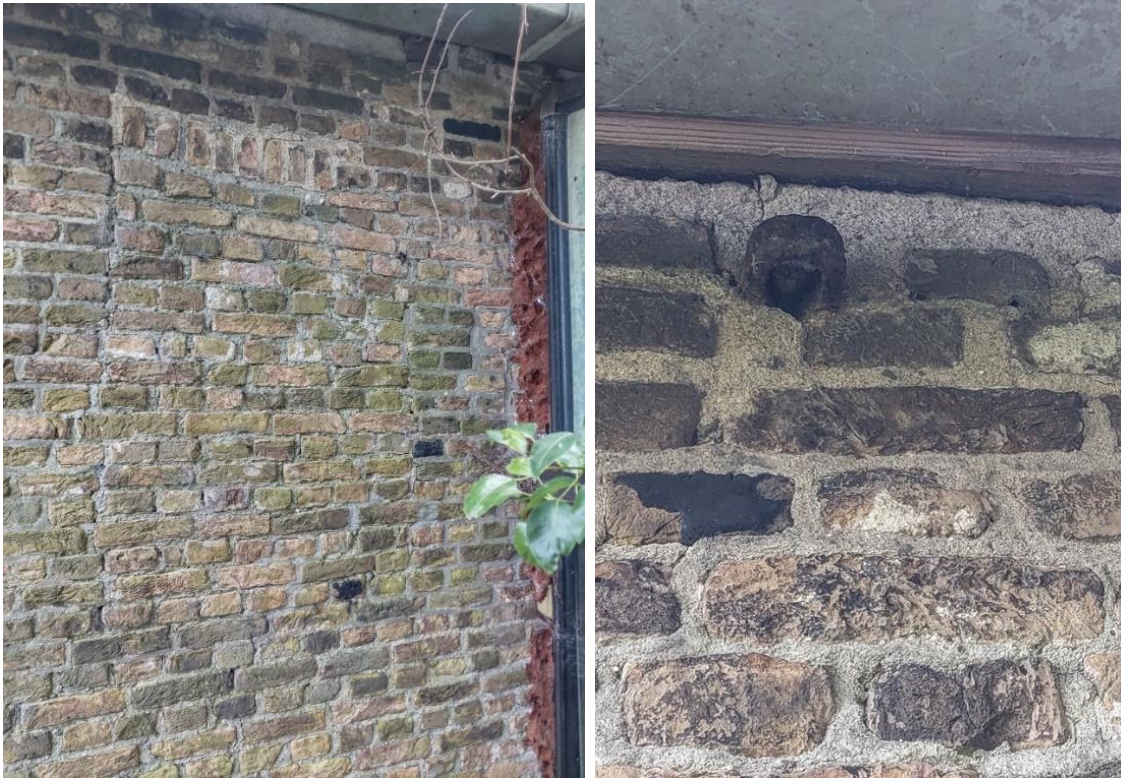
De dichtgezette gevelopening links in de gevel. Op de rechter foto is een balklaaganker te zien dat van de schieter is ontdaan. Tevens baksteen met beroeting en met restanten van pleisterwerk (en dus hergebruikt).
